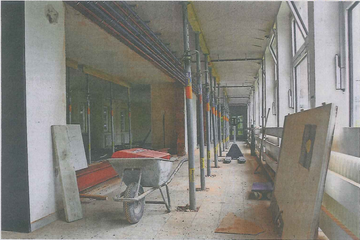
Für das kommende Jahr plant die Kreisverwaltung wieder eine Vielzahl von Baumaßnahmen. Handwerker aus der Region sollen profitieren. Foto Edel
